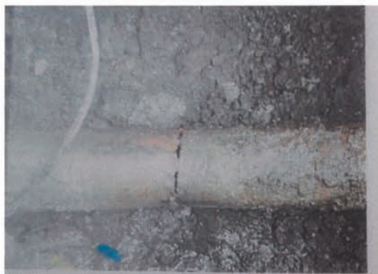
図5 CIPの被害例
