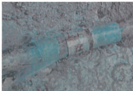
図6 SPネジ継手の被害例
