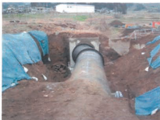
図 4 白石 IC 付近の管路の屈曲 (継手補修後) (1)
