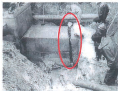
図2 スラストブロック破壊事例 (3)
