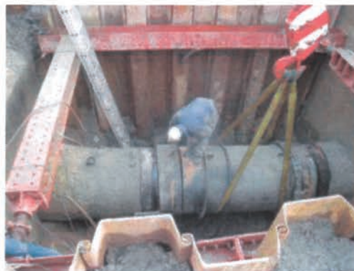
図 5 低区幹線 \phi 1200 鋼管の漏水箇所 (継手離脱) (1)
