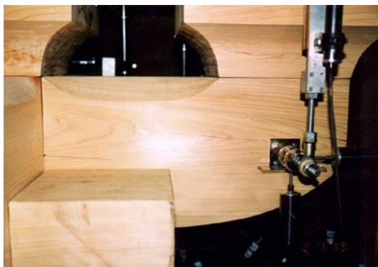
写真 3.2.14 杵肘木のひび割れ(南面・東側) 水平載荷実験 12/16 開始直前の状況
