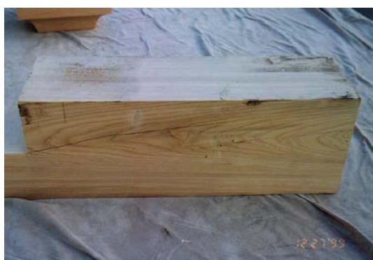
写真 3.2.40 通し肘木のひび割れ(南面・東側) 全実験終了後 12/27 の状況
